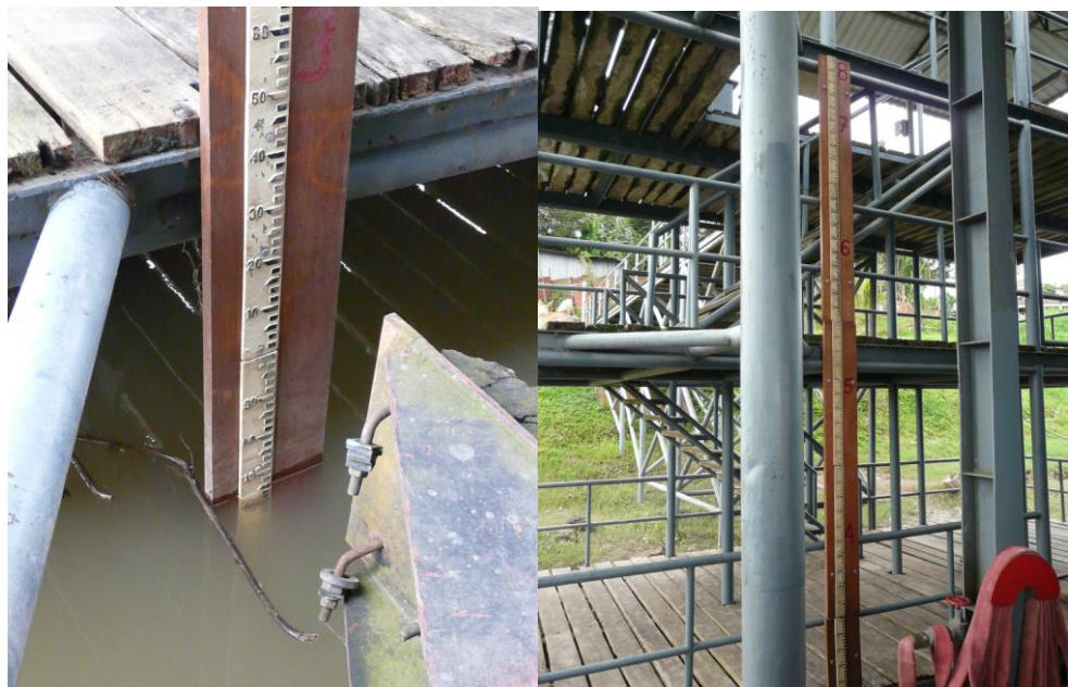
Fotografía 14.- Limnímetros instalados en la ciudad de Atalaya
